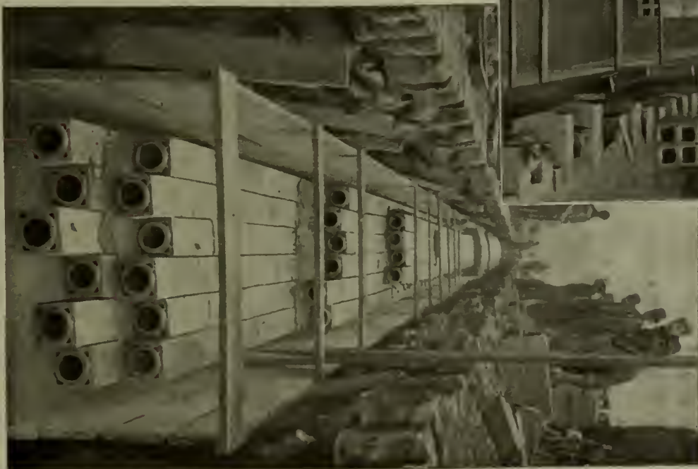
Conduits at Providence, R. I.
