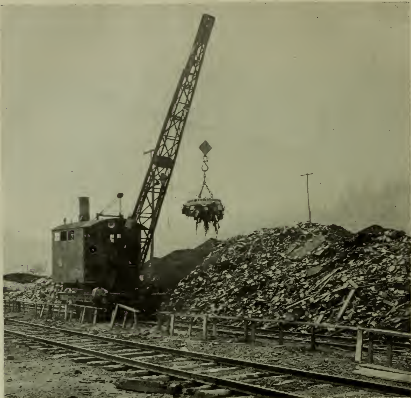
Fig. 179. — Grue électromagnétique des aciéries de Pittsburg.
