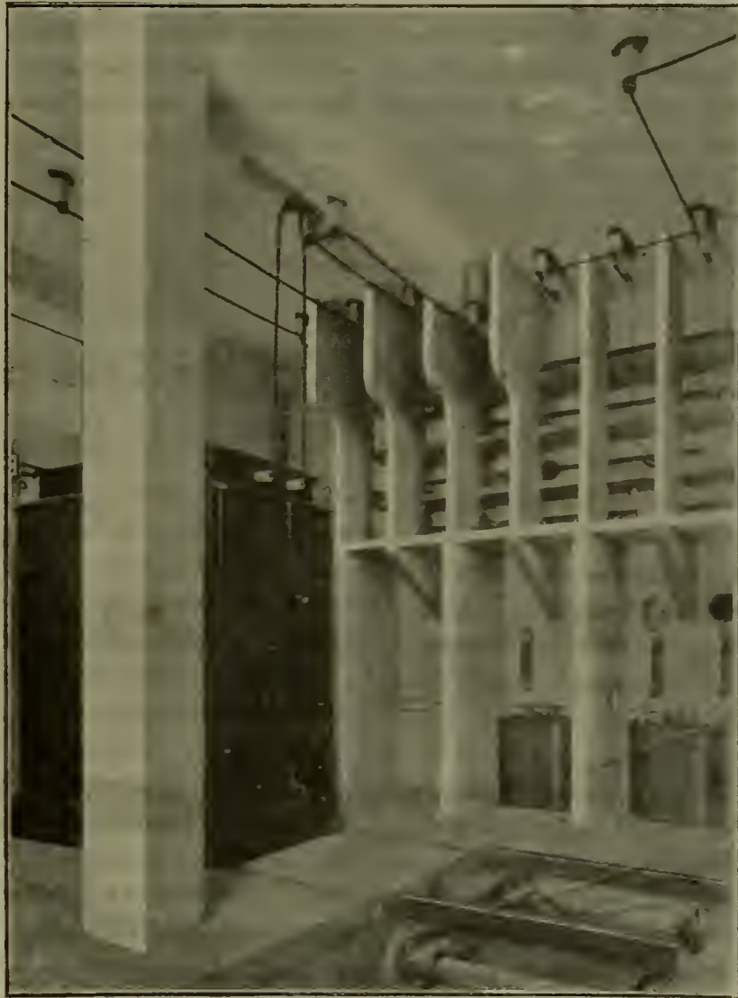
Fig. 152. — Tableau de distribution de la haute tension,
