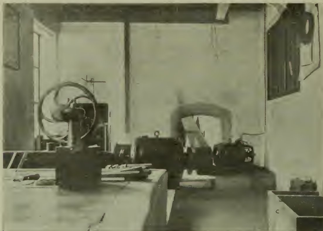
Fig. 243. — Intérieur de l'usine municipale de Villepreux.
