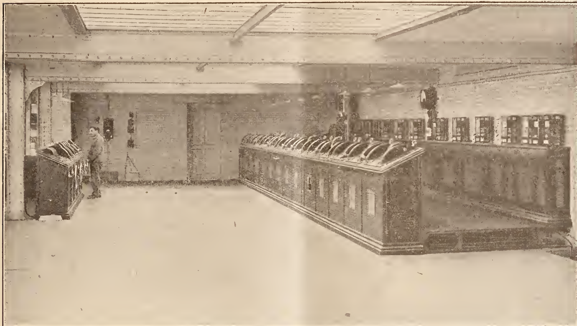
Société d'électricité de Paris. — Usine de Saint-Denis. (Pupitres de manœuvre).
